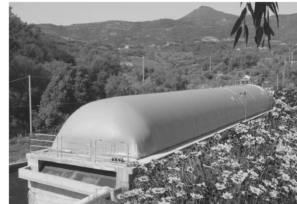
Una cupola gasometrica pressostatica realizzata con tessuto di fibre poliesteri spalmato PVC.
