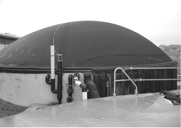
Digestore con cupola gasometrica colma di biogas.
