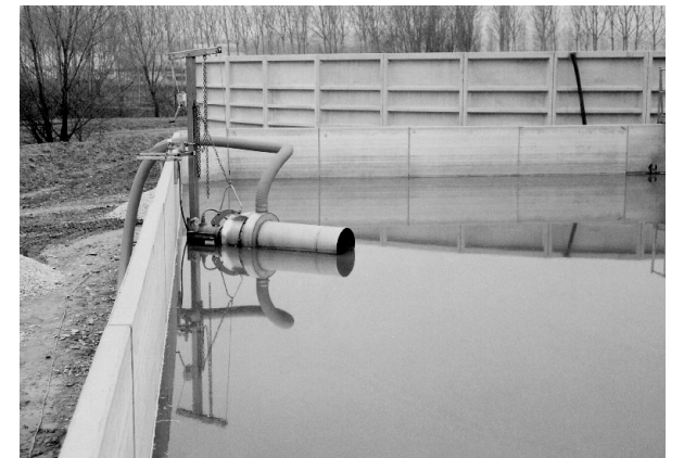
L'abbattimento dell'azoto tramite nitro-denitro è possibile grazie a particolari mixer sommergibili combinati con soffianti.
