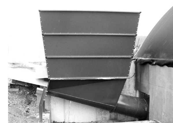
Tramoggia per il carico diretto della biomassa al di sotto del livello del liquido in digestione.
