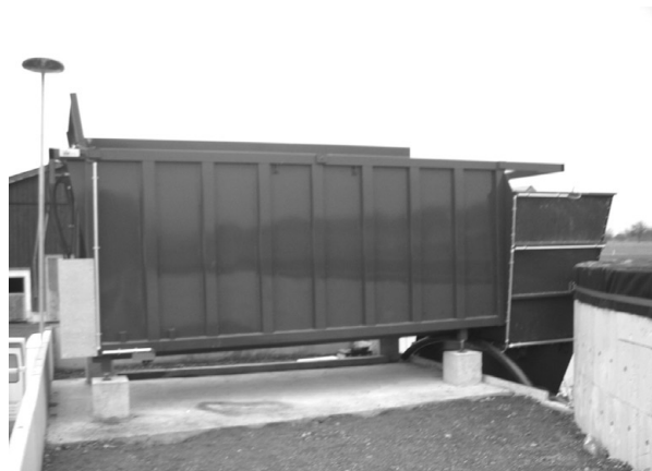
Cassone dosatore per automatizzare le operazioni di alimentazione del digestore.
