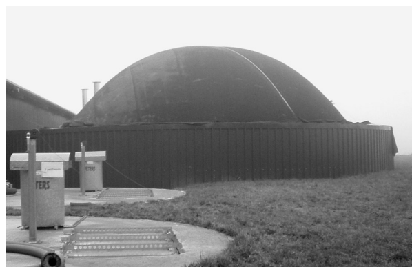
L'impianto di biogas mette a disposizione l'energia elettrica per la fase aerobica.
