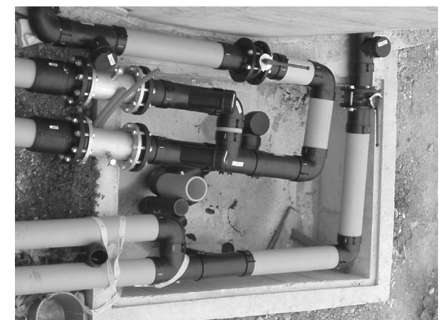
Raffreddamento e discreta essiccazione del biogas ottenuti senza alcun costo energetico con percorso interrato delle tubazioni.
