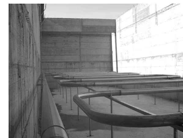
Particolare interno di un digestore "plug-flow" con serpentina di fondo per il riscaldamento.
