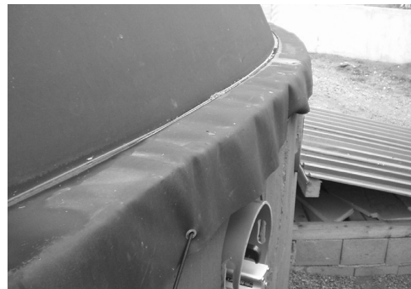
Semplice sistema pneumatico utilizzato per il fissaggio del telo gasometrico in EPDM "Biolene".
