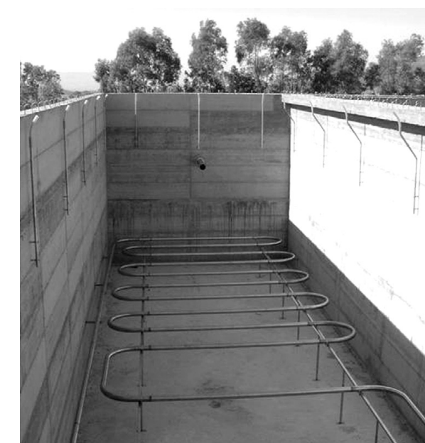
La distribuzione uniforme della serpentina per la circolazione dell'acqua calda assicura il riscaldamento omogeneo della massa.
