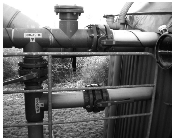
Tubazioni per la compensazione ed il prelievo del biogas.
