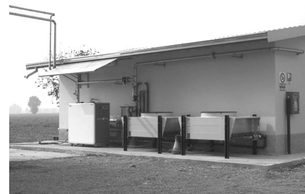
Sistemi di trattamento del biogas e smaltimento dell'energia termica in esubero.
