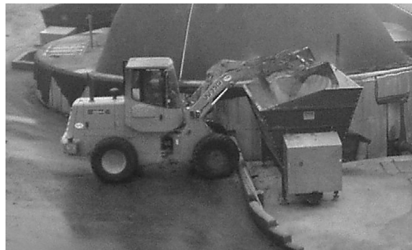
Rifornimento diretto di una tramoggia con biomassa prelevata dai silos di stoccaggio.
