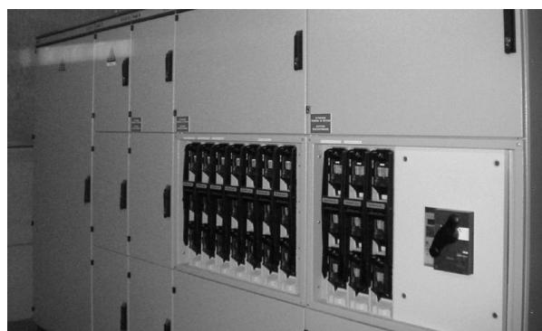
L'impiantistica elettrica condiziona l'efficienza e la sicurezza dell'impianto.
