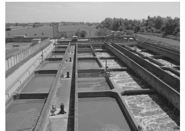
Il trattamento depurativo può essere utilizzato per la riduzione parziale dell'azoto nelle zone vulnerabili.
