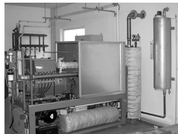
Cogeneratore con il generatore di corrente esterno al cofano di insonorizzazione del motore.
