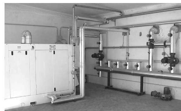
Collettore e linee in ingresso e uscita dell'acqua dal gruppo di cogenerazione.
