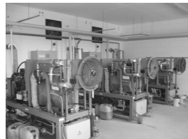
L'installazione dei gruppi di cogenerazione in un locale relativamente ampio rende agevole le varie manutenzioni.
