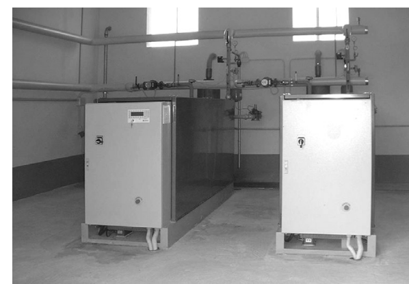
Cogeneratori dotati di quadro di controllo a "bordo macchina".
