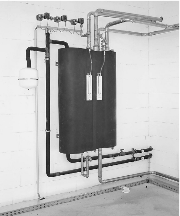
Il trattamento del biogas si completa all'interno del locale tecnico con appositi filtri.
