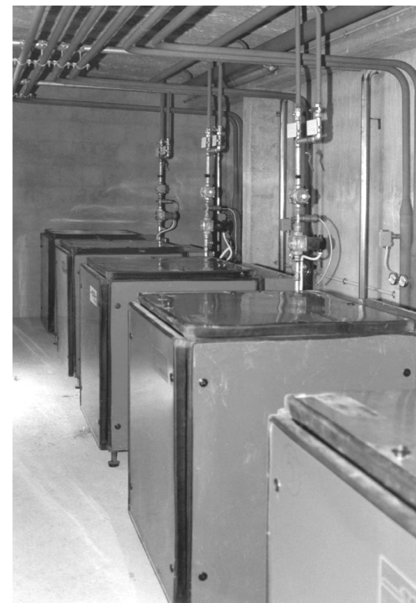
Cogeneratori in batteria dotati di cofano di insonorizzazione.
