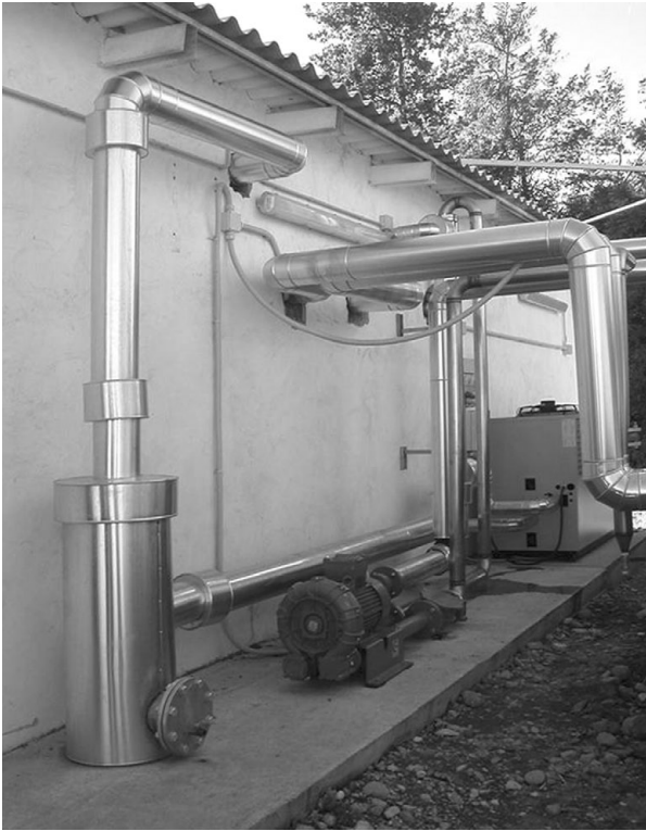
Impianto di deumidificazione del biogas con frigorifero.
