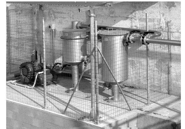
La ripresa del gas e la sua adduzione al cogeneratore può richiedere l'utilizzo di una specifica soffiante.
