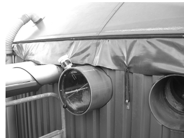
Speciali oblò per il controllo visivo dell'interno del digestore.
