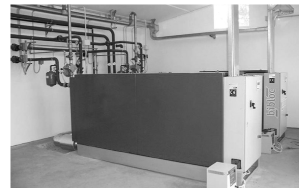
Cogeneratori installati in coppia in idoneo locale tecnico.
