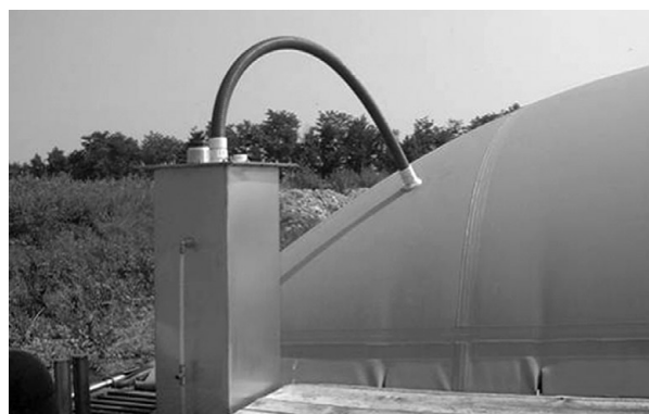
Valvola di sicurezza a guardia idraulica, per evitare sovrappressioni nel gasometro.
