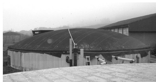
Un digestore anaerobico con cupola gasometrica in tessuto elastico EPDM.
