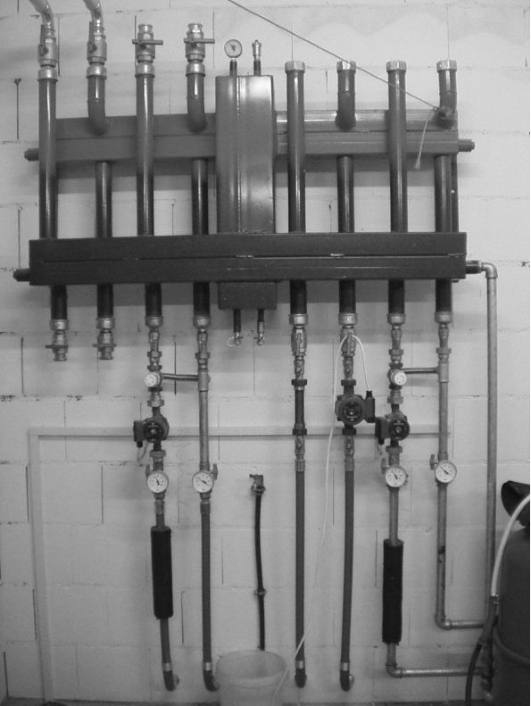
Per una ottimizzazione dei rendimenti termici è indispensabile prevedere l'interconnessione dei circuiti.
