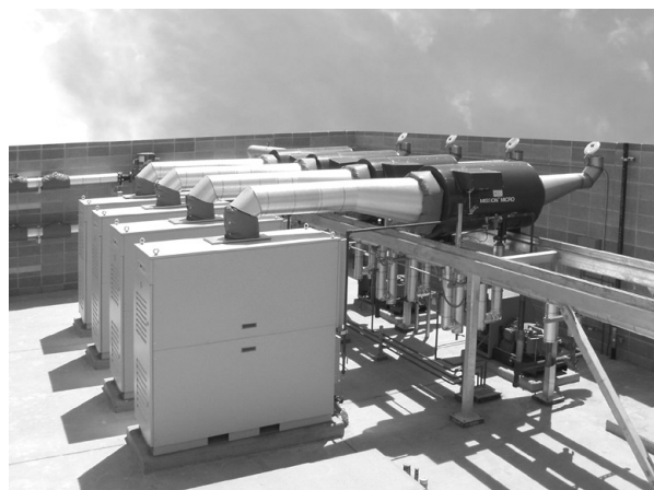
Gruppi di cogenerazione con microturbine preassemblate in batteria.
