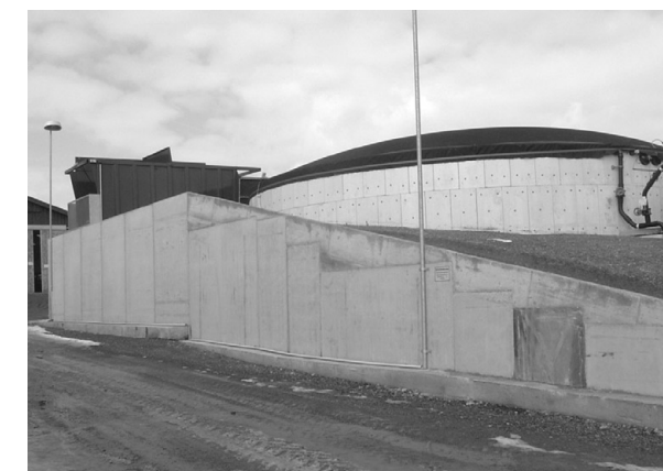
Cassone all'estremità della rampa, in grado di contenere tutta la biomassa da utilizzare nella giornata.
