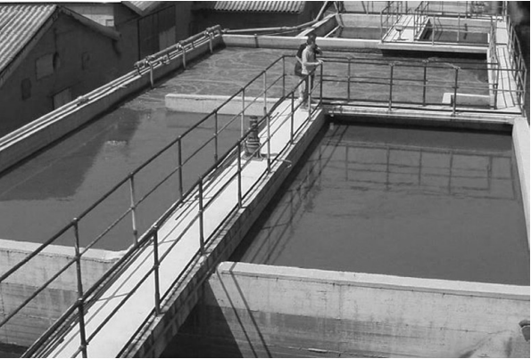
I comparti aerati di nitrificazione (sul fondo) e di denitrificazione in anossia (in primo piano).
